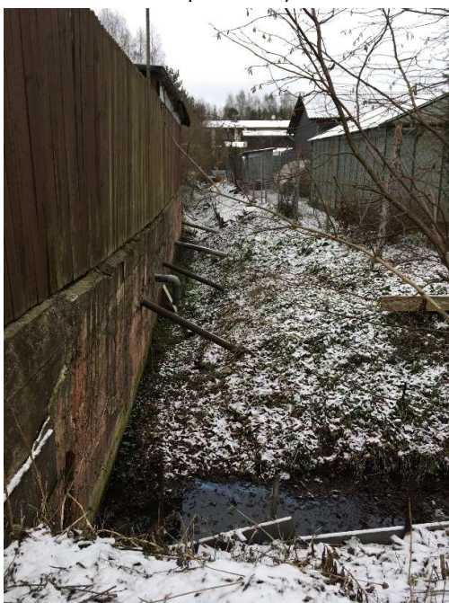
N-2. Ēka iebūvēta pa pusei grāvī.
