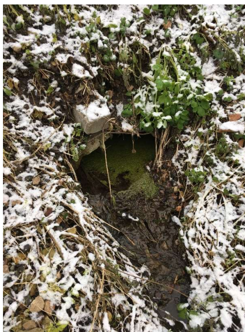
Tipiska caurteka objektā – mazs diametrs, aizaugusi, piesērējusi, caurvades spēja apgrūtināta
